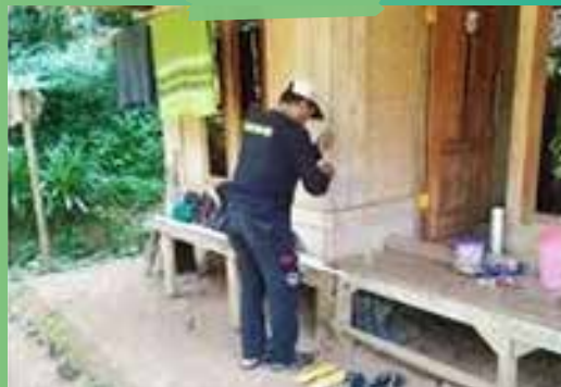
Pemasangan listrik untuk masyarakat sekitar pabrik Perseroan / Installation of electricity for communities around the Company's factory
